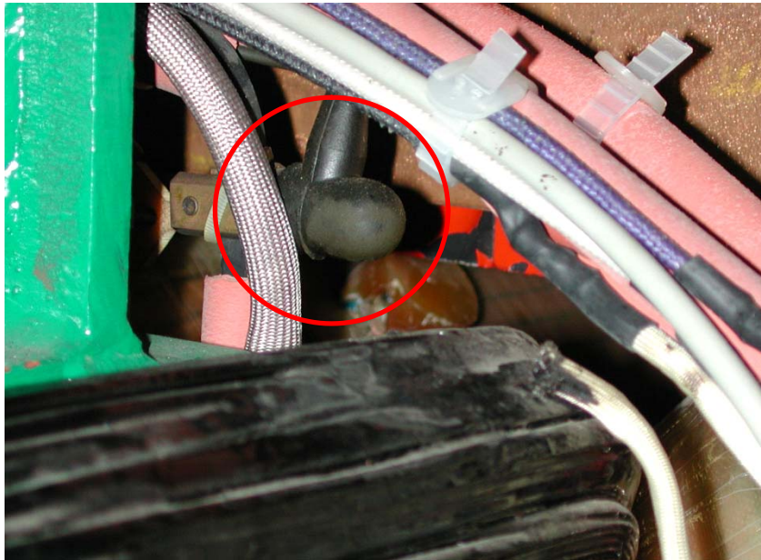
Figure 56 : protection d'un capteur de température usé par les radiations
