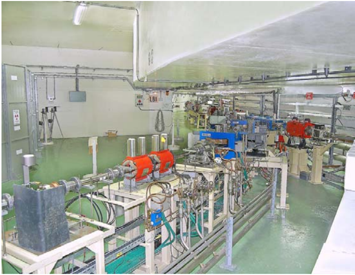
Figure 20 : photo panoramique de la ligne de transfert TL1
