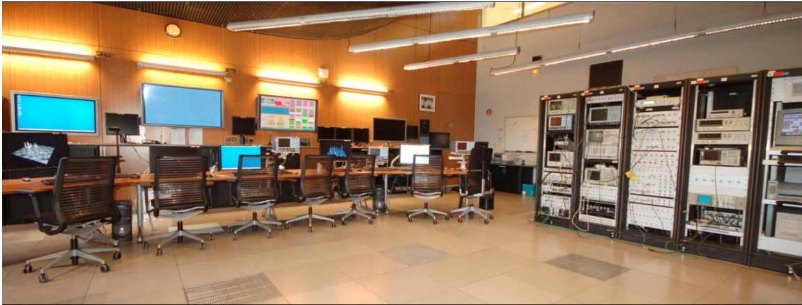
Figure 75 vue panoramique de la salle de contrôle
