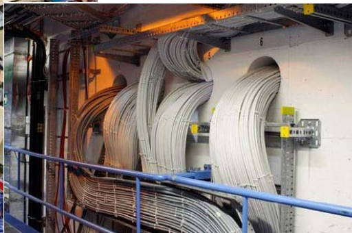
ATLAS Inner Det. Cables
