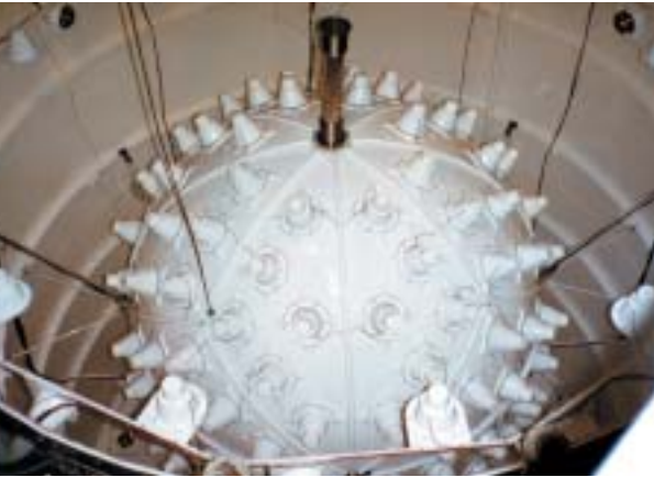
Détecteur de l'expérience Chooz en cours d'installation dans une galerie souterraine située à 1 km de la centrale nucléaire de Chooz dans les Ardennes. © CNRS/IN2P3
